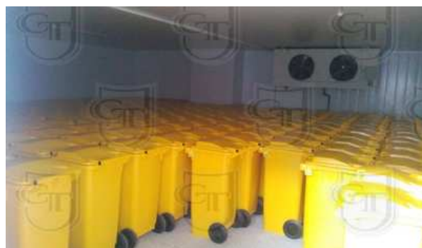
Холодильная камера для временного хранения медицинских отходов.
