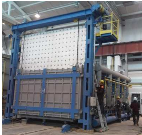
Термическая печь для термообработки эллиптических днищ диаметром до 3,4 м. Выкатной под. Рекуперативные горелки. Температура 1150 °С.
