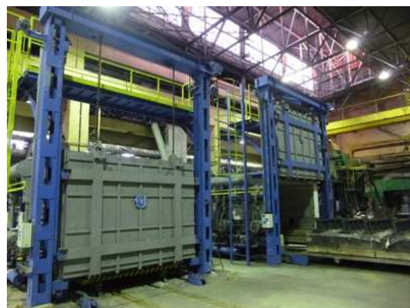
Термические печи. Садка 20 т Выкатной под. Рекуперативные горелки. Температура 1100 °С.
